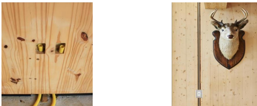
Figura 10 – Instalações elétricas embutidas e semi-arentes
