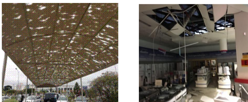
Figura 7 - Coberturas danificadas por chuva de granizo ocorrida em Lages/SC e região
