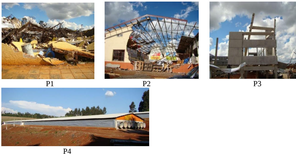
P1: ginásio totalmente destruído. P2, P3: edificações em alvenaria destruídas. P4: típico aviário que foi destruído e reformado, na região rural
